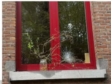
■ Sommige ramen gingen helemaal aan diggelen, andere zijn gebarsten.
